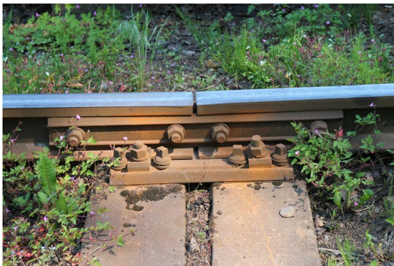
2 savienotas sliedes, ar spraugu priekš termiskās izplešanās Draceane, CC BY-SA 4.0, via Wikimedia Commons
